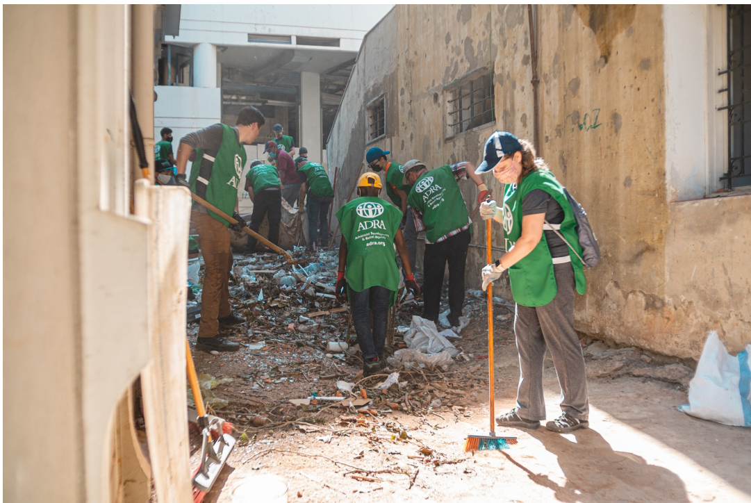
ADRA-Helfer bei Aufräumarbeiten nach der Explosion in Beirut © ADRA MENA/Libanon
